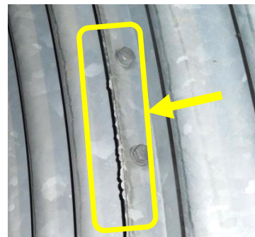
図6 現場施工後の膨潤状態
